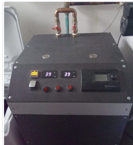
Kocioł w codziennej pracy — zasilanie c.o. w starym domu
